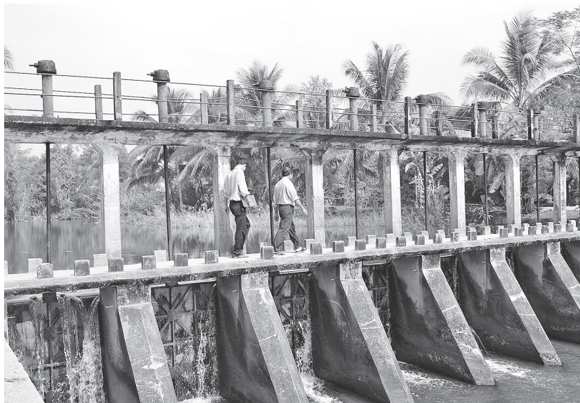
Cán bộ Phòng NN&PTNT huyện Tân Phú kiểm tra công trình đập dâng Năm Sao trên địa bàn
