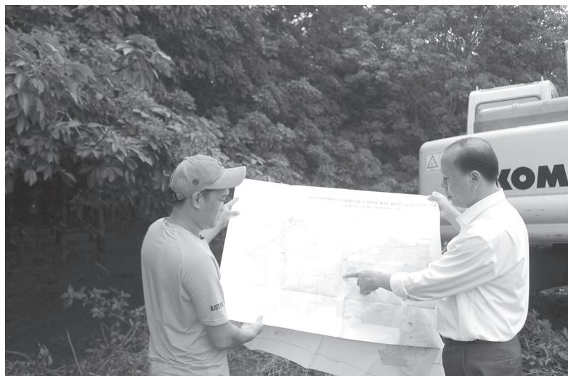
Kiểm tra mặt bằng xây dựng Cụm công nghiệp chế biến nông sản Long Giao (huyện Cẩm Mỹ)
