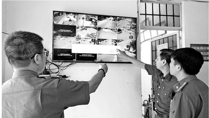
Cán bộ, chiến sĩ Công an phường Thống Nhất (thành phố Biên Hòa) kiểm tra hệ thống camera an ninh để theo dõi tình hình an ninh trật tự trên địa bàn phường
