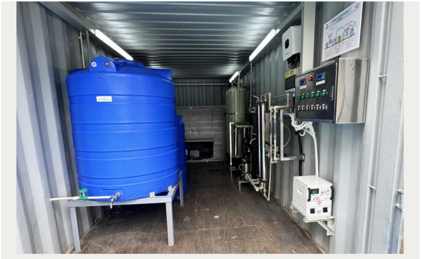
Hệ thống lọc nước nhiễm phèn, mặn lắp đặt tại
