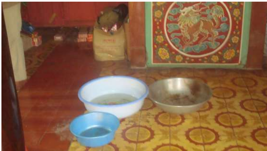
Mưa thấm khu vực thờ tự của đình mỗi khi trời mưa
