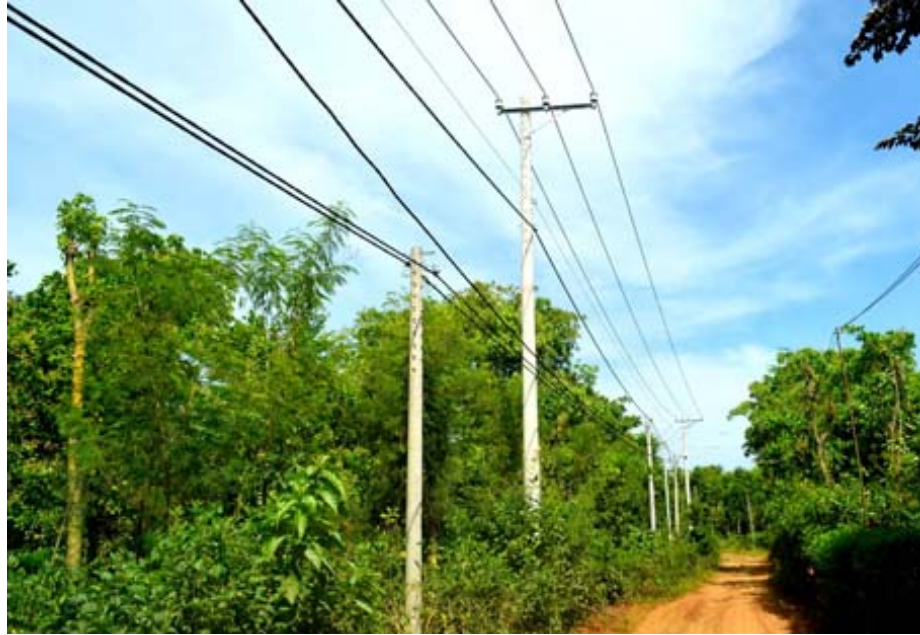
Đường dây hạ thế dẫn vào ấp 7, xã Phú Lộc (huyện Định Quán) (Nguồn : Internet)
