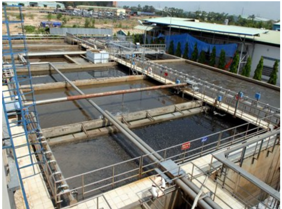
Nhà máy xử lý nước thải tại KCN Biên Hòa II.
