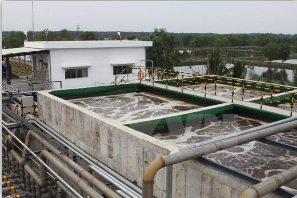
Hồ xử lý độ màu khu vực xử lý nước thải.
