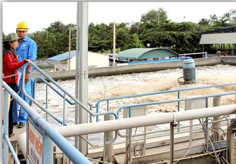
HĐND tỉnh tổ chức kiểm tra hệ thống xử lý nước thải tại Khu công nghiệp Biên Hòa 2.
