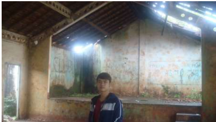
Nhà điếm hiện nay đã xuống cấp nghiêm trọng cần kịp thời sửa chữa
