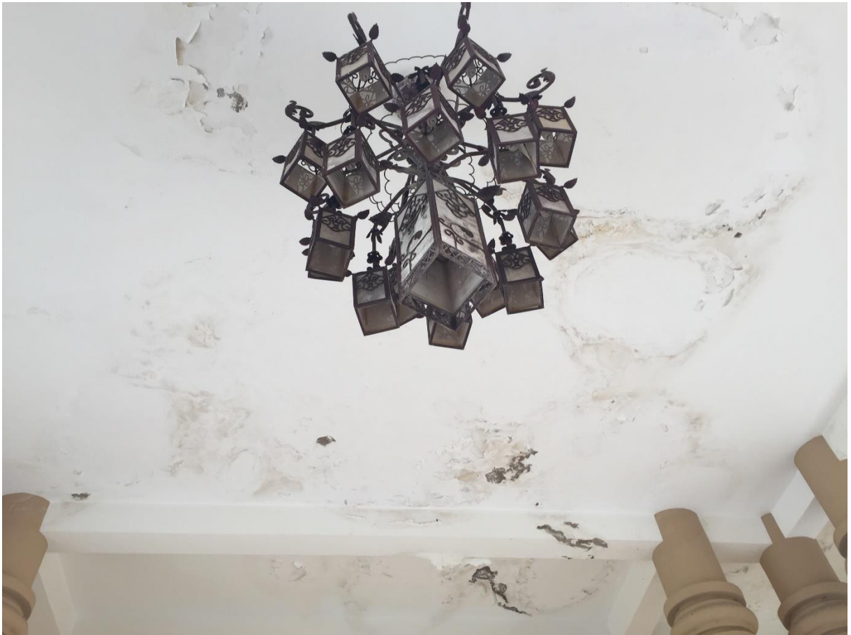
Trần nhà Khuê Văn Các bị thấm nước
