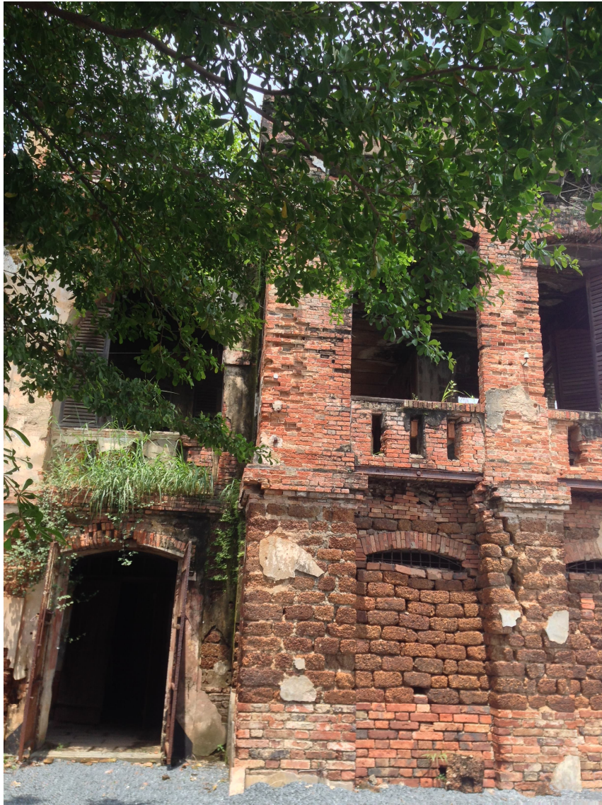
Thành Biên Hòa- nơi diễn ra trận tấn công của bộ đội Huỳnh Văn Nghệ vào Tỉnh lỵ Biên Hòa năm 1946 hiện đã xuống cấp nghiêm trọng
