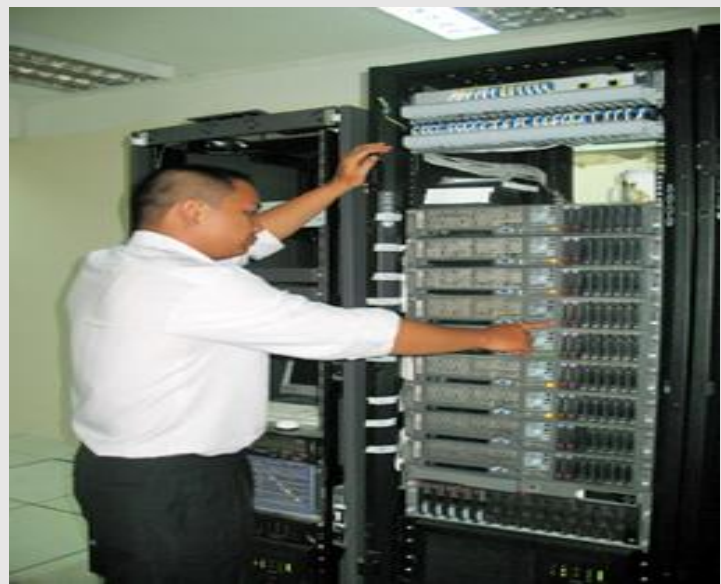
Ảnh: Phòng Datascenter thuộc Trung tâm phát triển phần (đơn vị đang chuyển đổi theo Nghị định 115/NĐ-CP (Nguồn: dost-dongnai.gov.vn)
