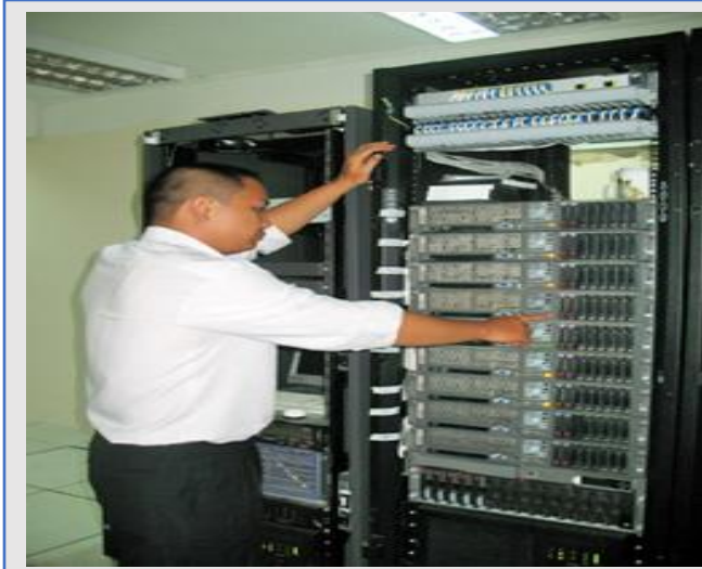
Ảnh: Phòng Datacenter thuộc Trung tâm PTPM (đơn vị đang chuyển đổi theo Nghị định 115/NĐ-CP (Nguồn: dost-dongnai.gov.vn)
