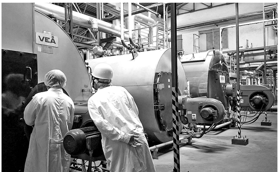
Lò hơi là thiết bị có yêu cầu nghiêm ngặt về an toàn, vệ sinh lao động và được quản lý bằng Quy chuẩn kỹ thuật Quốc gia QCVN 01: 2008/BLĐTBXH
