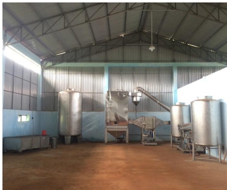
Hình 3. Hệ thống máy hạ thủy phần
