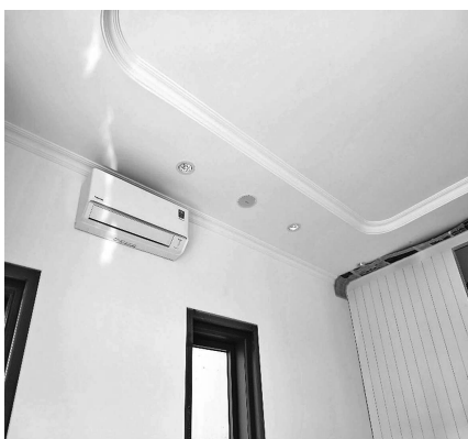
Hệ thống chiếu sáng, âm thanh đa vùng, rèm cửa tự động, AI camera tại một công trình của tỉnh Lâm Đồng.
