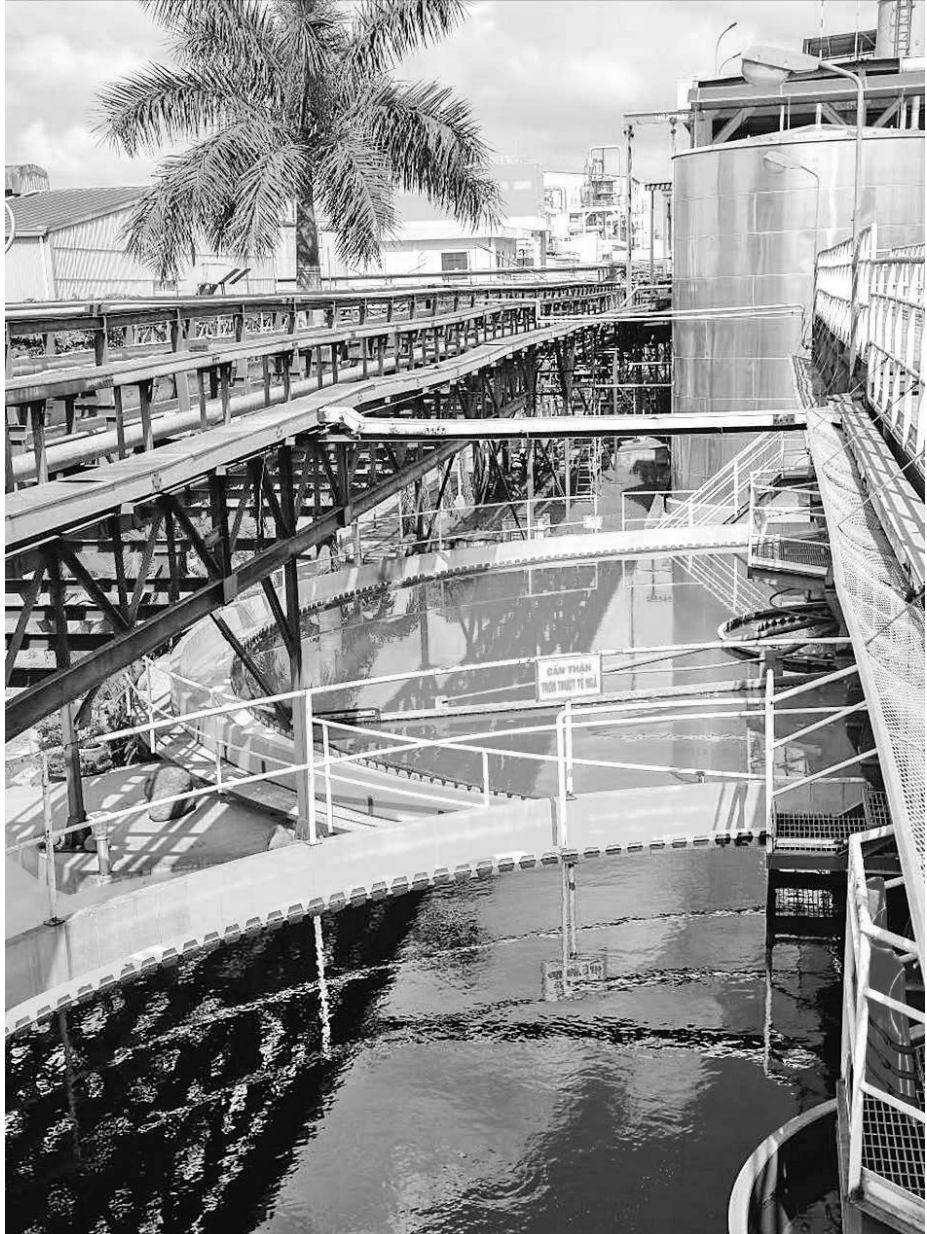
Hệ thống tuần hoàn nước thải tại Công ty Ajinomoto Việt Nam.
