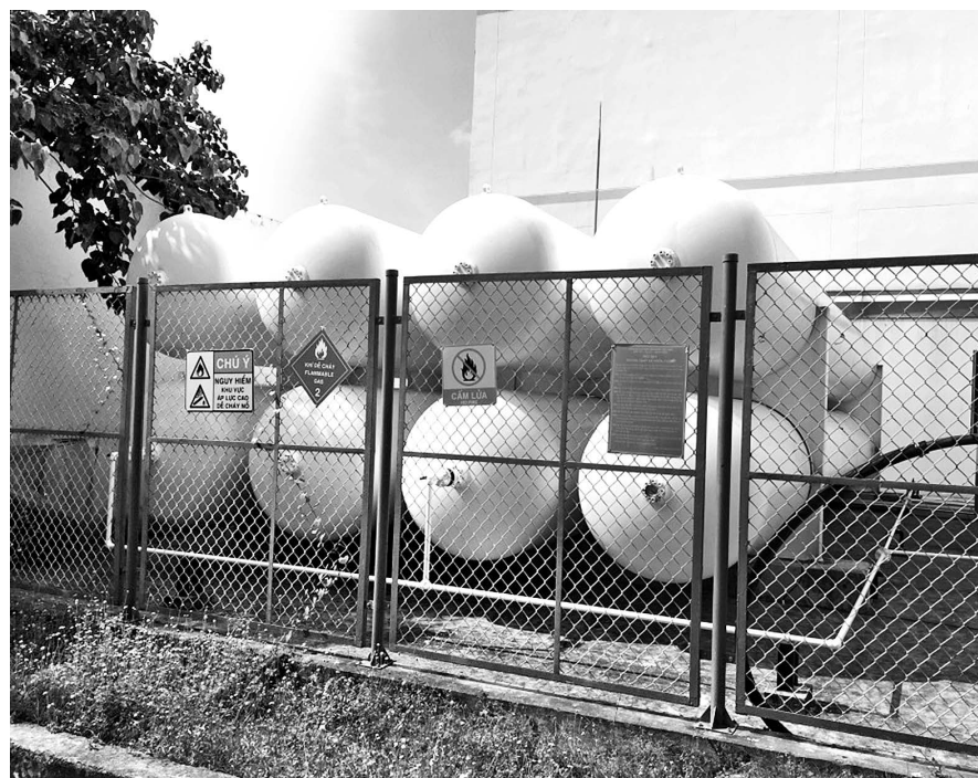
Hình ảnh Hệ thống khí CNG tại công ty Meiwa
